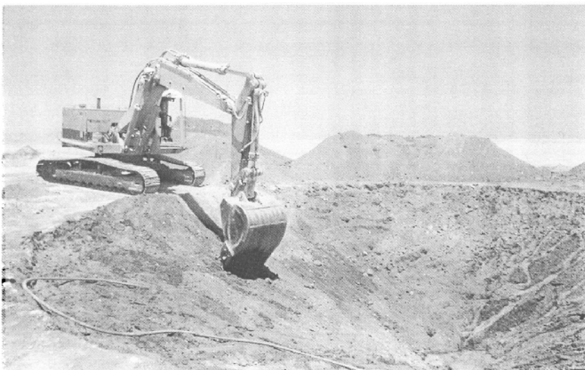
Αναπνοή της Ερήμου. Από τις εργασίες κατασκευής του έργου και δημιουργίας κώνων
